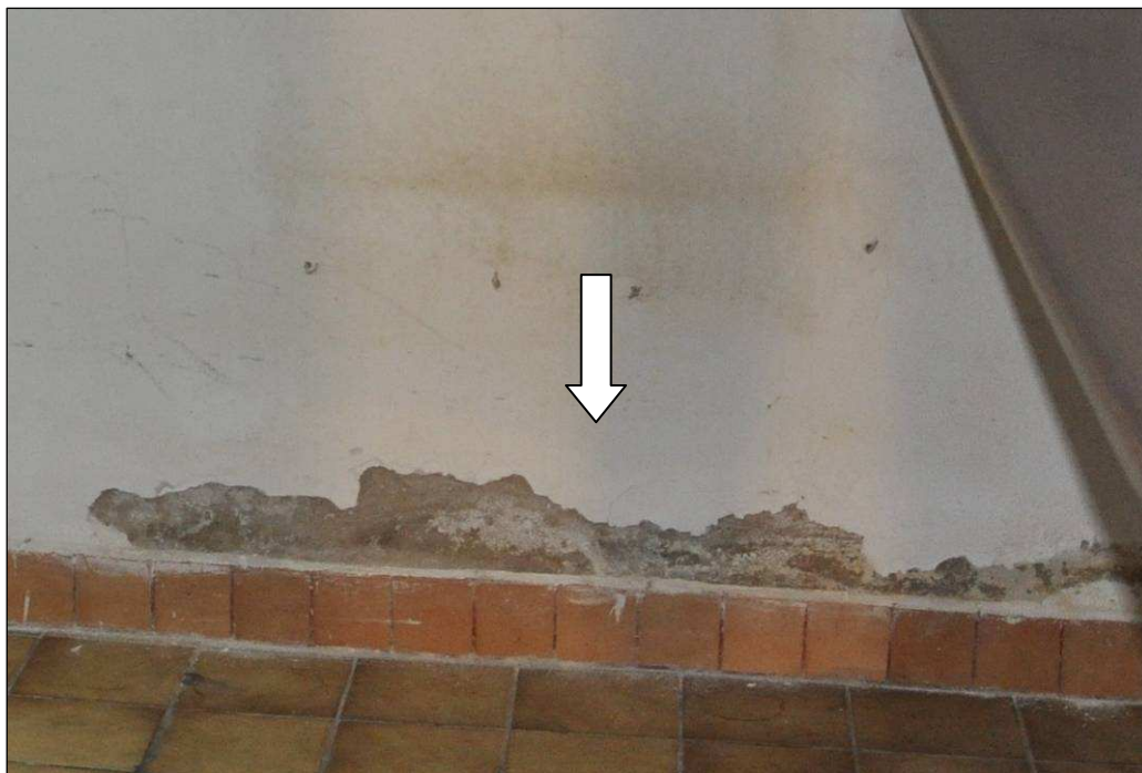
Ściana cokołowa pomieszczenia nr -1.9 (zaplecze kawiarni Maska) Widoczne wysolenia na warstwach tynku.
