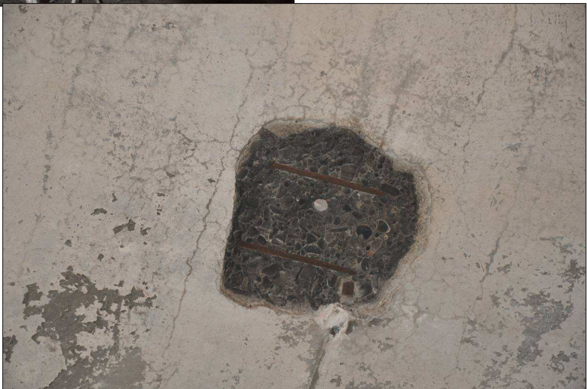
Fot. 14 Kraków, Stary Teatr, plac Szczepański1/ul. Jagiellońska 1 – piwnice, komora nr -1.4, fragment stropu żelbetowego. Stan zachowania przed konserwacją Grudzień 2011r, M.Wida
