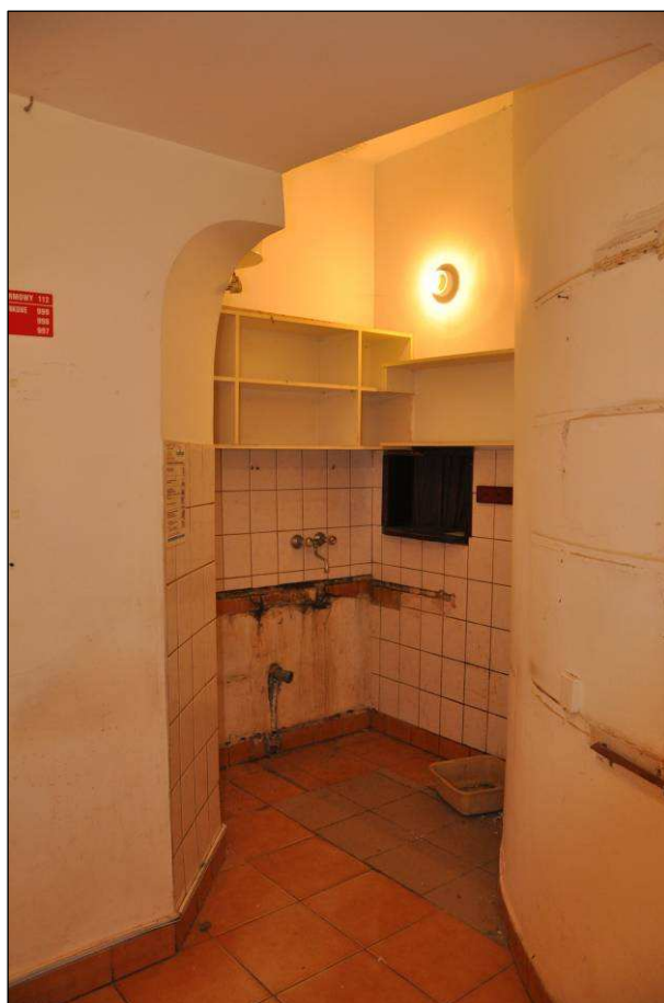
Fot. 26 Kraków, Stary Teatr, plac Szczepański1/ul. Jagiellońska 1 – piwnice, komora nr -1.9 zaplecze kuchenne dawnej kawiarni Maska Stan zachowania przed konserwacją Grudzień 2011r, M.Wida
