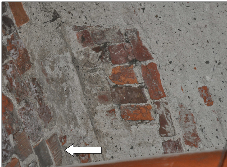
Fragment sklepienia i ściany w komorze -1.3. Pod warstwą tynku cegła o zdestruowanej powierzchni, w ścianie uzupełnienia współczesną cegłą
