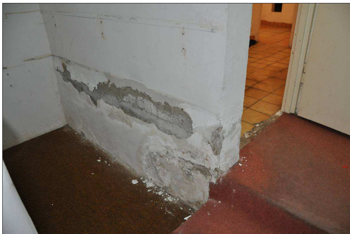
Fot. 27 Kraków, Stary Teatr, plac Szczepański1/ul. Jagiellońska 1 – piwnice, komora nr -1.9 zaplecze kuchenne dawnej kawiarni Maska, widoczne zasolenie tynków. Stan zachowania przed konserwacją Grudzień 2011r, M.Wida
