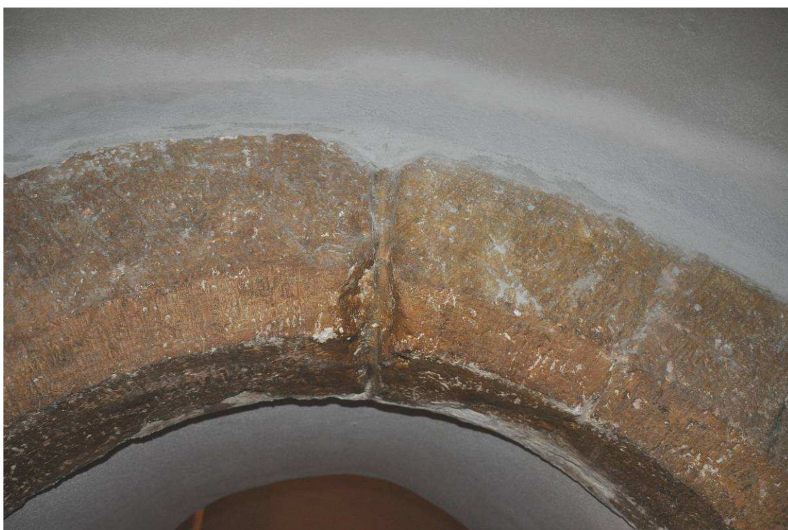
Fot.11 Piwnice Starego Teatru w Krakowie, pom. nr. -1.7, fragment nadproża portalu. Czerwiec, M.Wida
