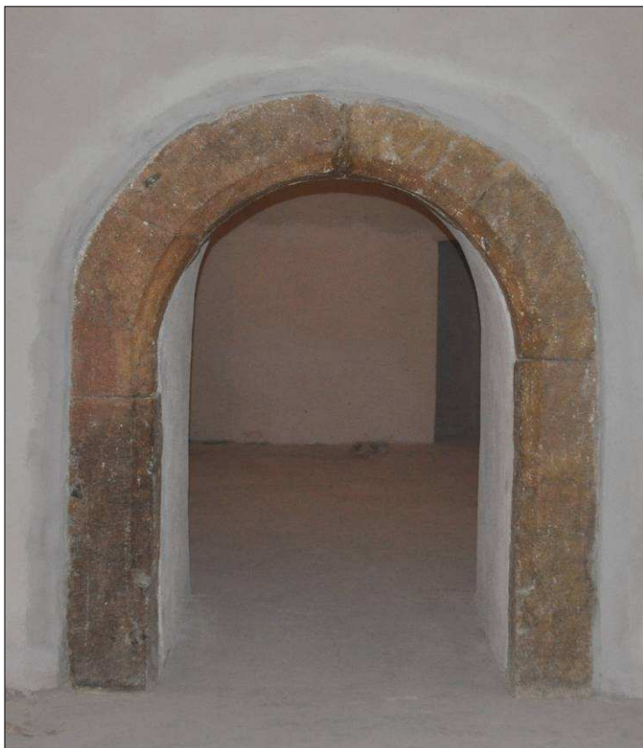
Fot.10 Piwnice Starego Teatru w Krakowie, pom. nr -1.7, portal z wapienia jurajskiego (pokryty pokostem) do konserwacji zachowawczej (w części opisowej określone jako zad.3). Czerwiec, M.Wida
